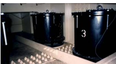
図9 歩道橋桁内に設置された TMD
