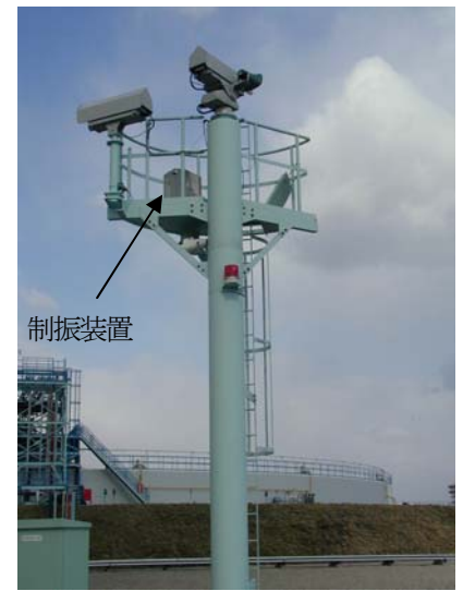
図5 監視カメラ柱
