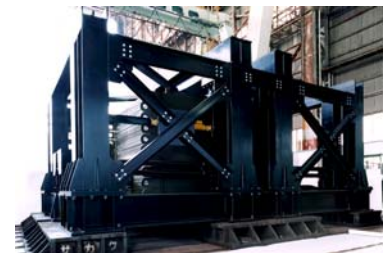
図14 ビルに設置した TMD
